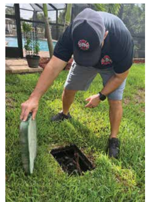
El propietario, Dom Prochilo, inspecciona la caja de válvulas del sistema de riego en busca de fugas visibles.
